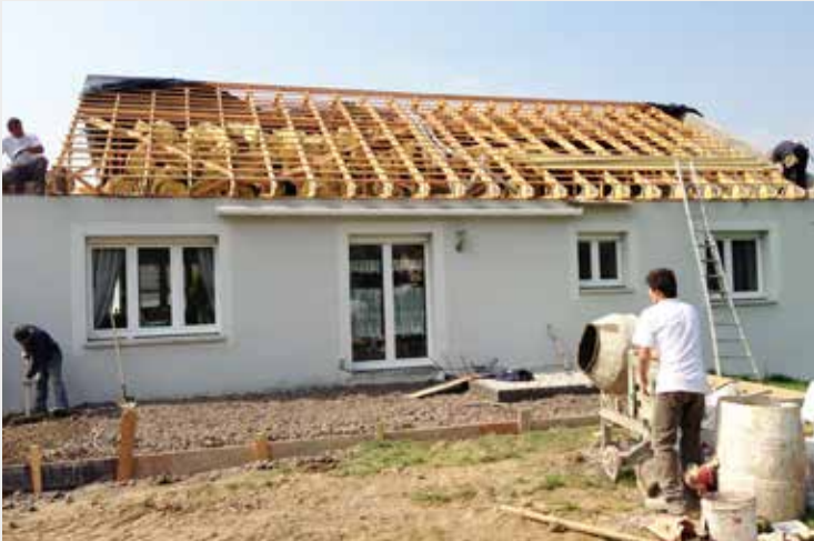
Le moment clé du chantier : découverte et démontage de l'ancienne charpente, la maison toujours occupée.
